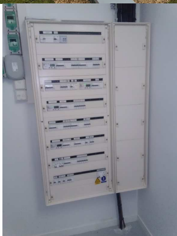
Armoire électrique du bâtiment reliée au compteur linky
